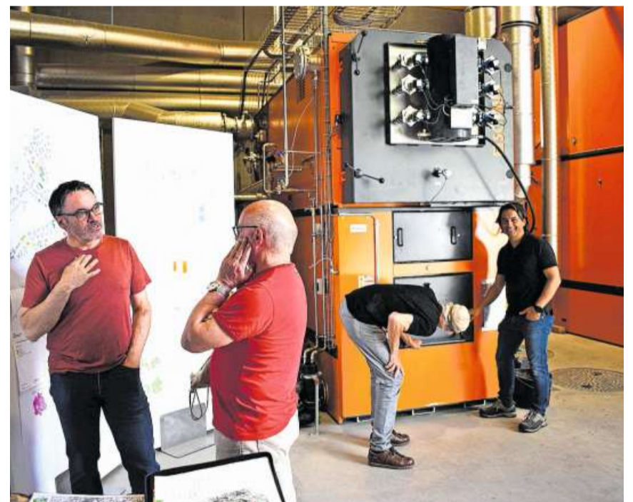
Frühlingsmarkt-HGH: reges Interesse an der Holz-schnitzel-Heizzentrale. Förster Robi Püntener (links) und Oliver Weisbrod (rechts) erklären den Betrieb.
